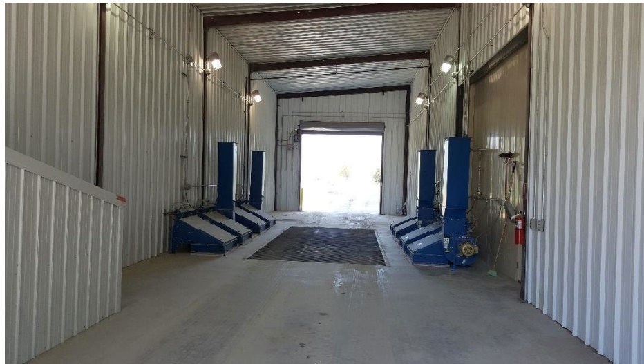
Figura 4.5. Pozo de recepción de camiones de carga, con rejilla de alta resistencia y sistema de supresión y control de polvo. Tenga en cuenta las herramientas de limpieza, incluidas las escobas, palas y los barajados, que cuelgan de la pared para facilitar el acceso a la limpieza del área del pozo receptor después de que se hayan descargado los camiones.
