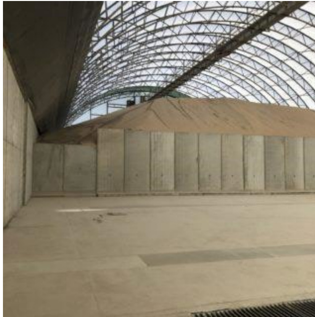
Figura 4.12. Almacén de almacenamiento de fondo plano que muestra un mamparo de hormigón para dividir la capacidad de retención de granos e ingredientes de piensos.
