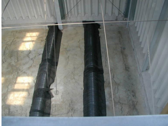
Figura 4.18. Sistema de aireación semipermanente que muestra conductos perforados en el piso de media ronda para airear el grano en un edificio de almacenamiento plano antes de que se llene
