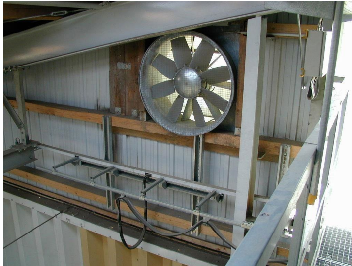
Figura 4.17. Alto flujo de aire, ventilador de escape de baja potencia eléctrica que ventila el aire del espacio de cabeza de un edificio de almacenamiento plano.
